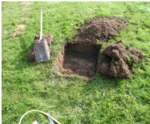
2. Der udgraves mindst to prøvehuller ned til det niveau, hvor faskinen skal ligge. Selve prøvehullet skal være min. 0,25 m x 0,25 m og mindst 0,3 m dybt. Hullerne skal ligge mindst 5 m fra hinanden
